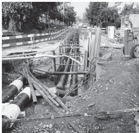
Fernwärmeleitung in der Schänzlistrassen.
