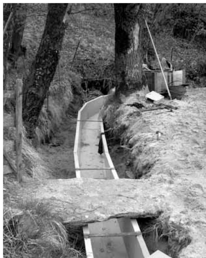
Wasserleitung in Eggerberg.
