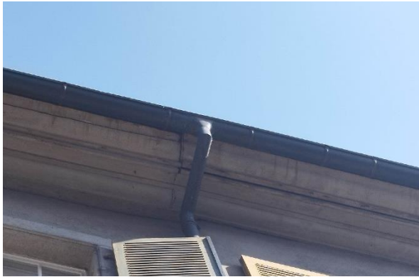
Abgeblättert resp. fehlende Farbschicht Holzuntersicht
