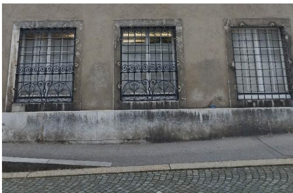
Abplatzungen / Risse und Verfärbungen Fassadenputz
