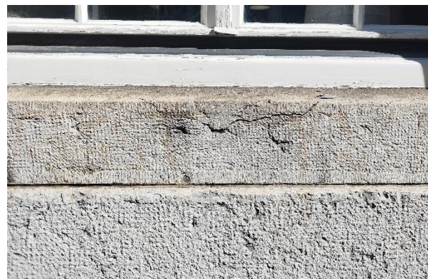
Abplatzungen, gerissene oder fehlende Fugen
