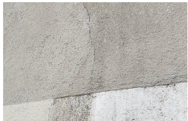
Abplatzungen / Risse und Verfärbungen Fassadenputz
