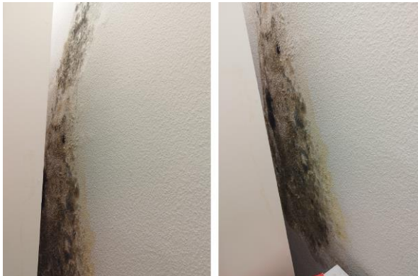
Schimmelbildung infolge Undichtheit
