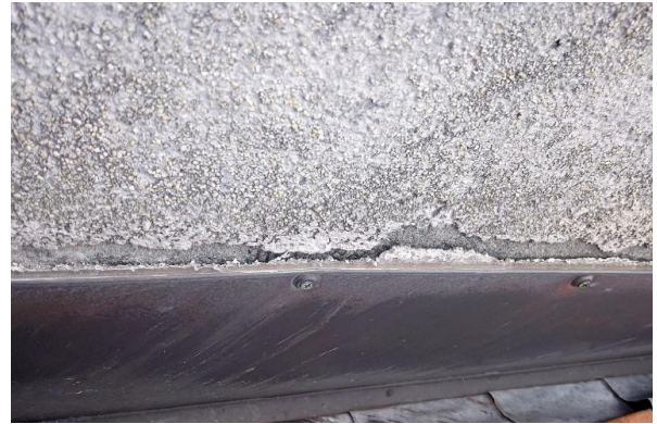
Rissbildung im Bereich Blechanschluss
