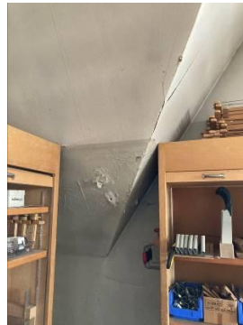
Wasserschaden Klassenzimmer 2. OG
