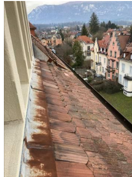
deformierte, korrodierte Bleche
