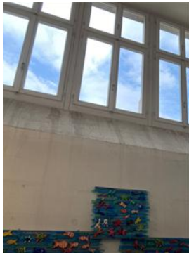
undichte Fenster 2. und 3. OG
